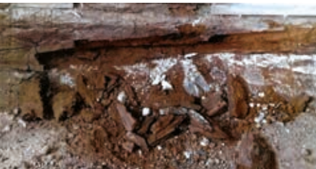
Würfelbruch an der Schwelle
