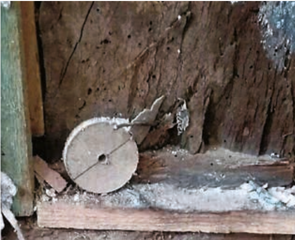
Holzwurmbefall an der Stütze
